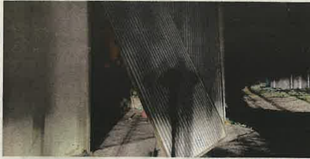
Les services techniques de Longueville ont subi d'importants dégâts DR
