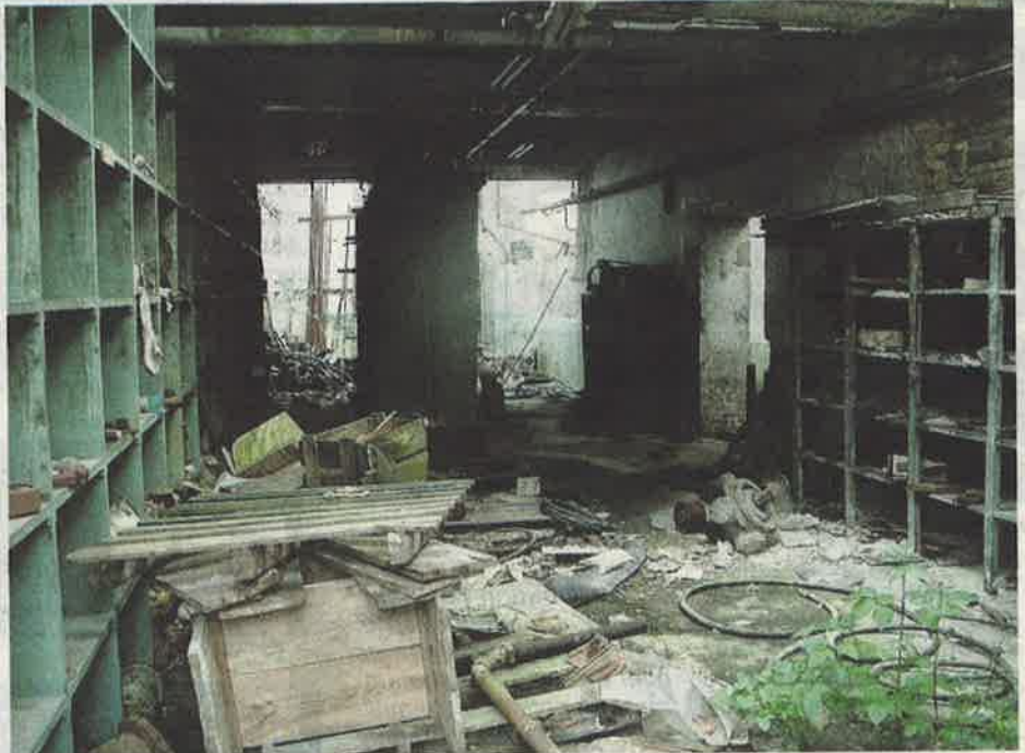
L'état des friches de l'ancienne usine Degond menace l'espace public. La mairie a voté une taxe dans l'espoir de faire réagir le propriétaire.
