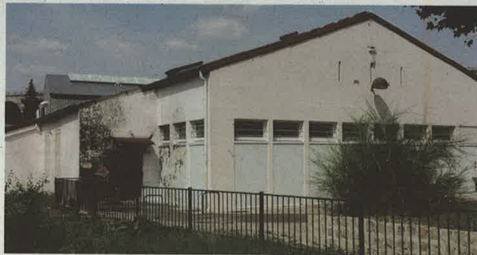
Un feu de poubelle a endommagé la salle des fêtes de la commune, située place du 8 mai 1945
